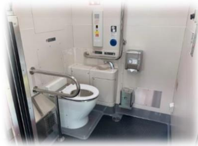
電車内のバリアフリートイレ
