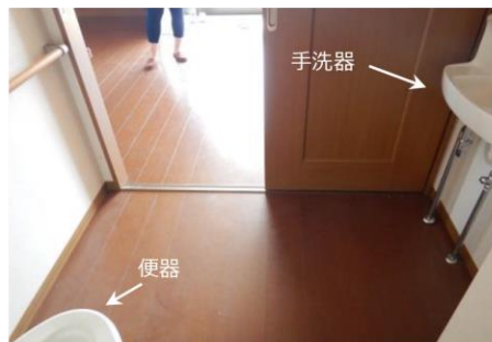
図3. トイレ内の手洗器設置状況
